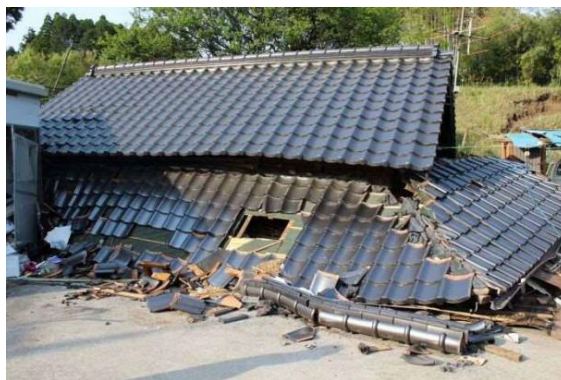
写真 2.7 熊本地震における救出箇所
